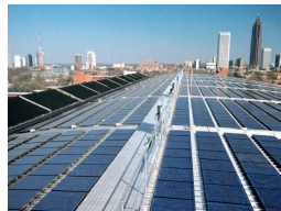
(d) Roof-top solar
