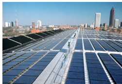
(d) Roof-top solar
