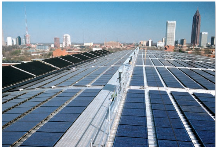
(d) Roof-top solar
